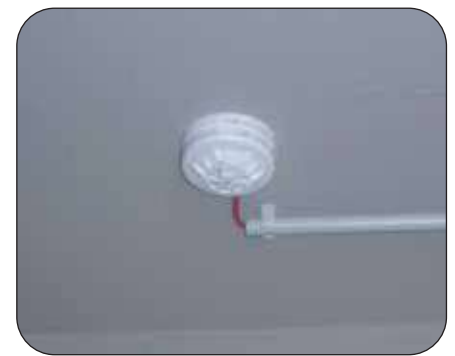
Wärmemelder zur Ansteuerung der Türfeststellanlage
