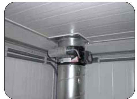
Abluftkanal mit K-90 Absperrvorrichtung
