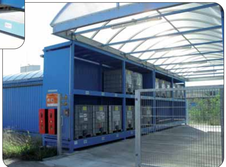
◆ Lagerbereich für IBC/KTC
