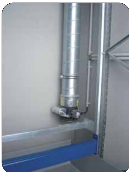
Ex-Abluftanlage inkl. brandgeschützter Lüftungselemente
