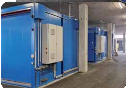
◆ Brandschutzcontainer wurden im Gebäudekomplex (Erdgeschoss) integriert
