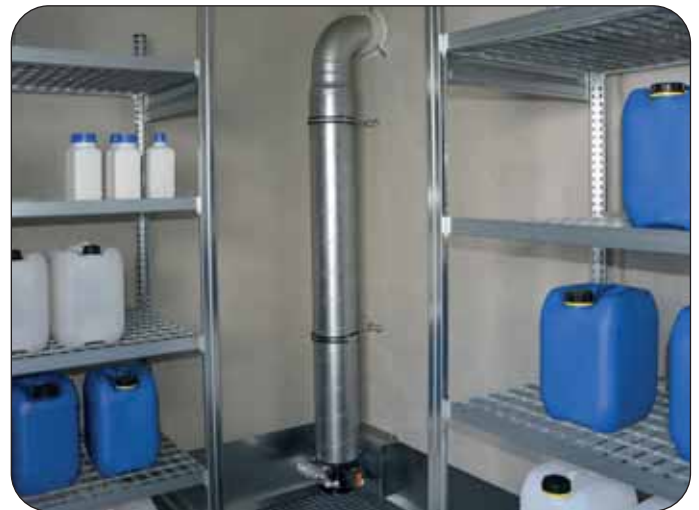
Ex-Abluftanlage inkl. Abluftkanal bis Auffangwanne
