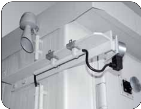
- Ex-geschützte Abluftüberwachung mit Signalhupe - Türhalteanlage
